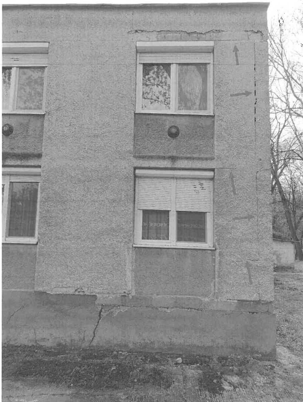
6. kép: a nyugati homlokzat déli vége; jól láthatók a repedések a fal teljes magasságában
