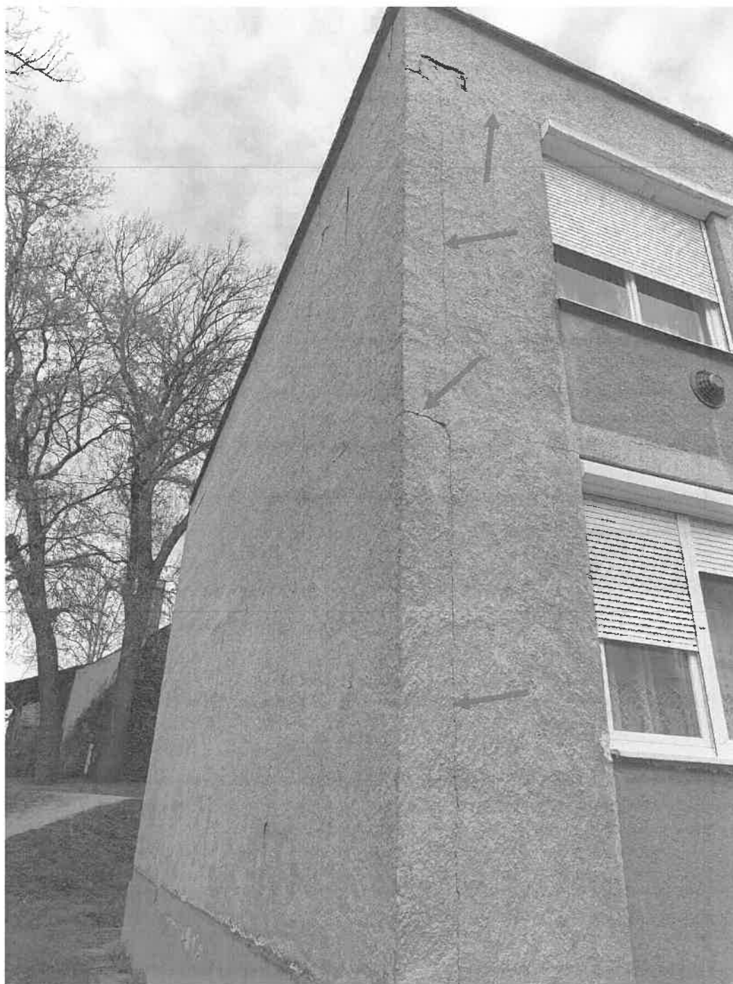
3. kép: az épület dél-keleti sarka; jól láthatóak a fal repedései
