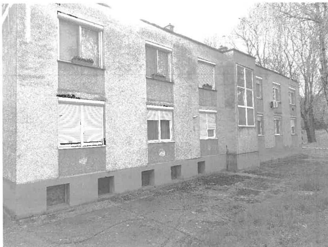
9. kép: az épület nyugati homlokzata melletti, kb. 3 m-es betonozott tér, erősen mohás, nedves
