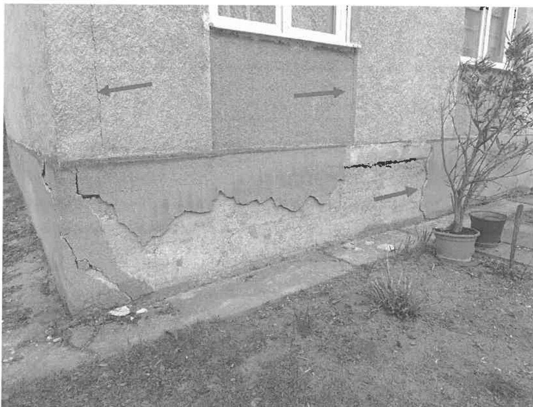
2. kép: a keleti homlokzati fal és lábazat déli végén látható repedések, a beton lábazat eltört
