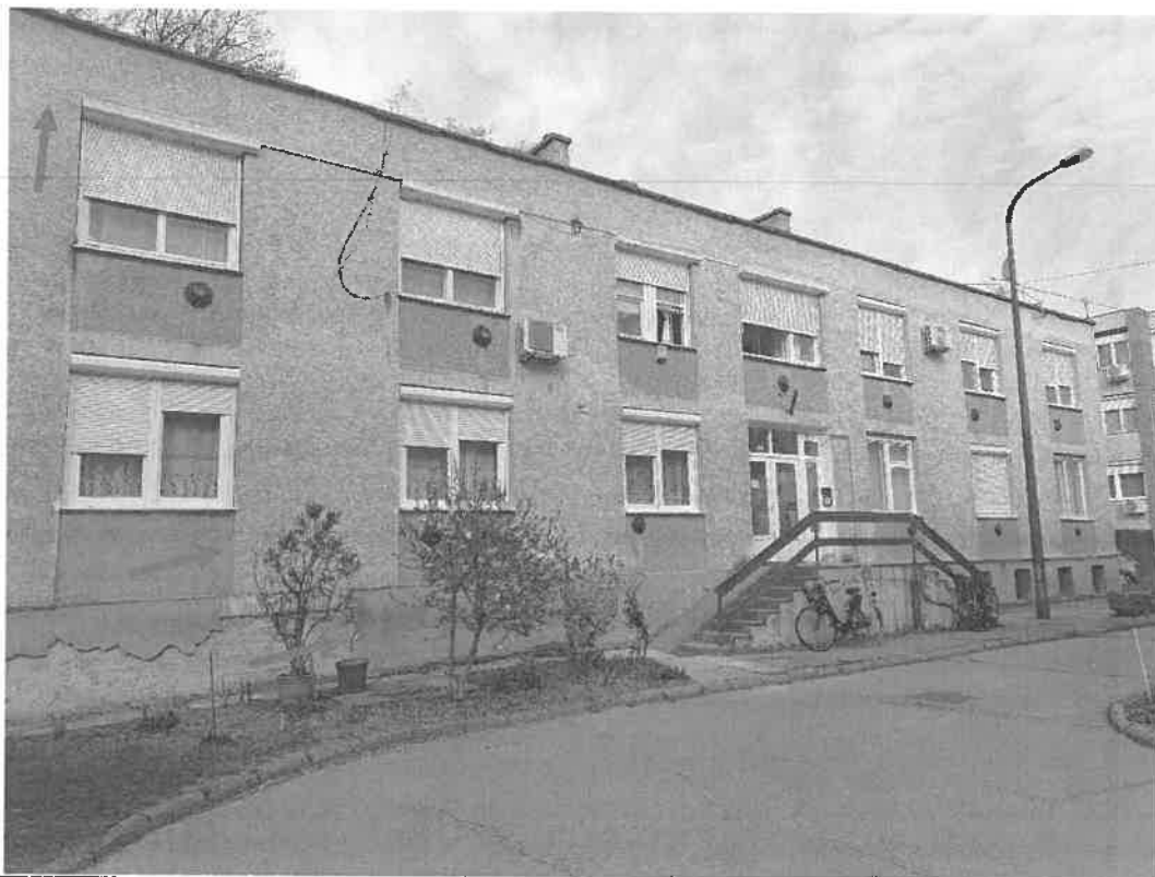
1. kép: az épület keleti homlokzata; nyilakkal jelöltük a repedéseket
