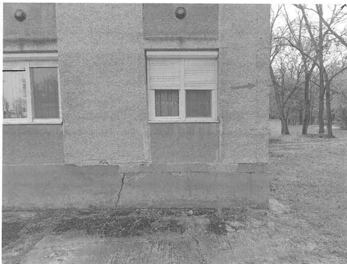
5. kép: a nyugati homlokzat déli vége; jól láthatók a repedések
